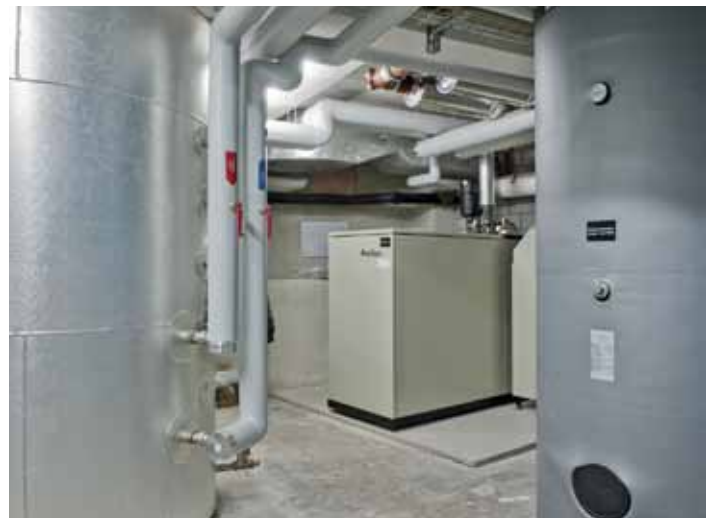
Das BHKW Powertherm, links und rechts die Speicher
