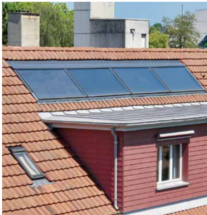
10 m 2 Solarkollektoren, integriert im Dach
