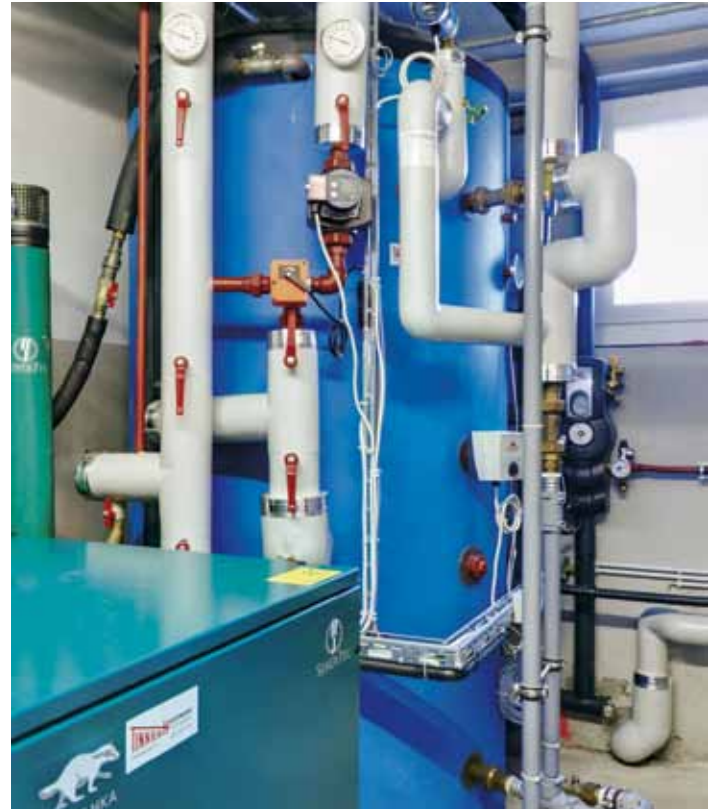
Der 1000 l-Kombispeicher liefert das Warmwasser
