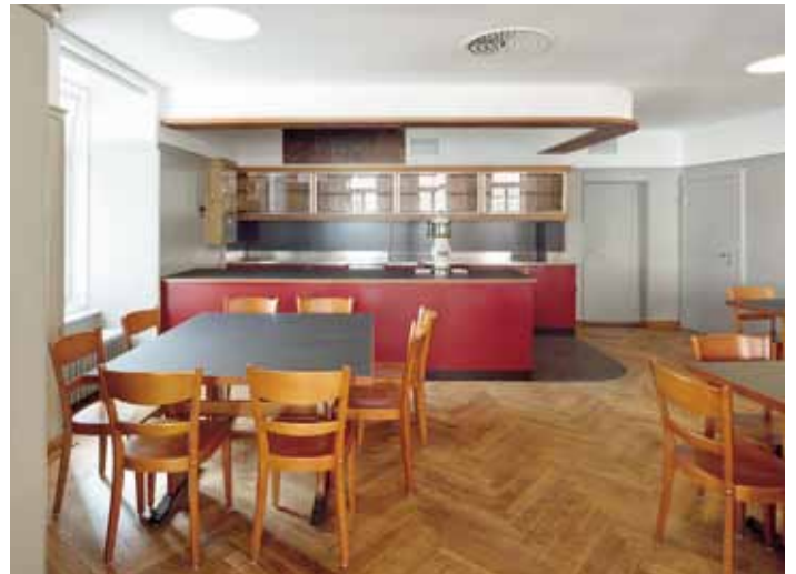
Der Speiseraum, oben sichtbar in der Decke die Komfortlüftung
