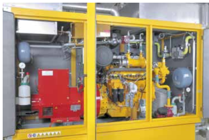
Das geöffnete BHKW. Es produziert 115 kW e und 167 kW th
