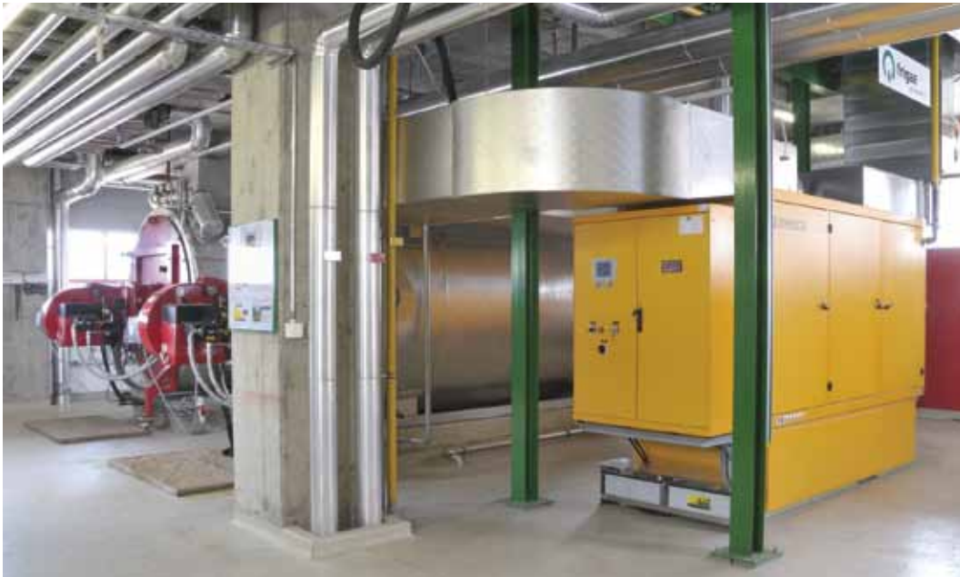
Hinten links die beiden Zweistoffbrenner, rechts (gelb) das BHKW
