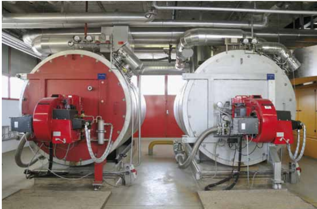
Die beiden Zweistoffbrenner Erdgas/Heizöl von Weishaupt mit je 2,0–2,5 MW Leistung
