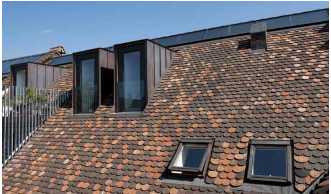
14 m² Solarzellen, platziert an der oberen Dachkante
