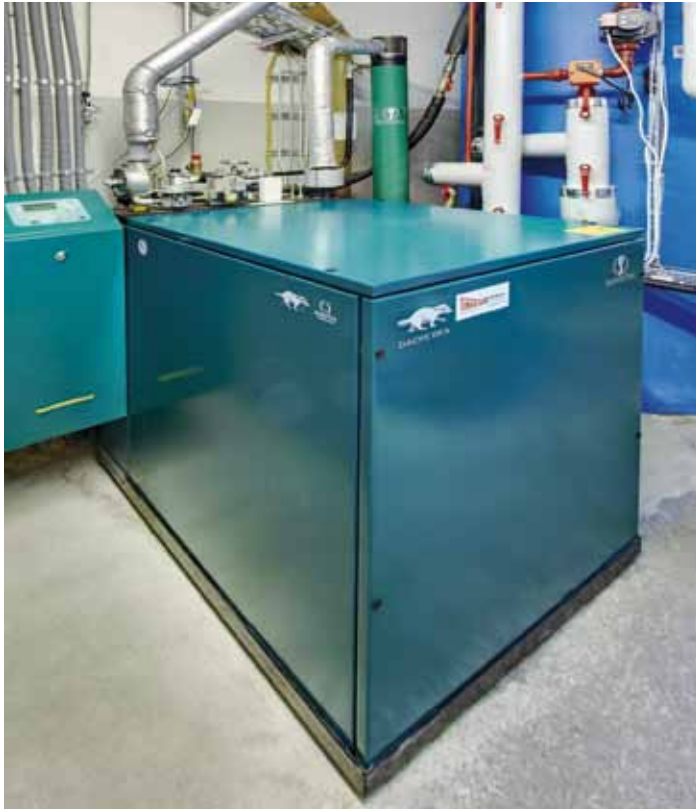
Das Sachs-BHKW produziert jährlich ca. 45 000 kWh
